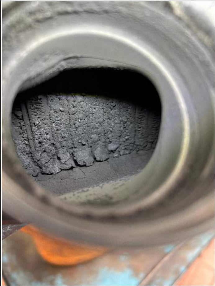
Charge Air Cooler 1.JPG
